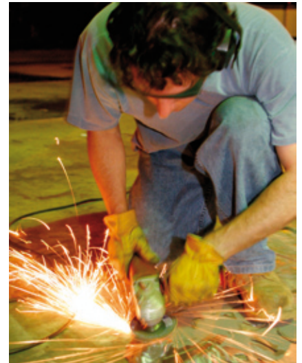
Fig. 4.3 L'empresari ha de posar les mesures de protecció adequades i el treballador ha de tenir-les en compte.
